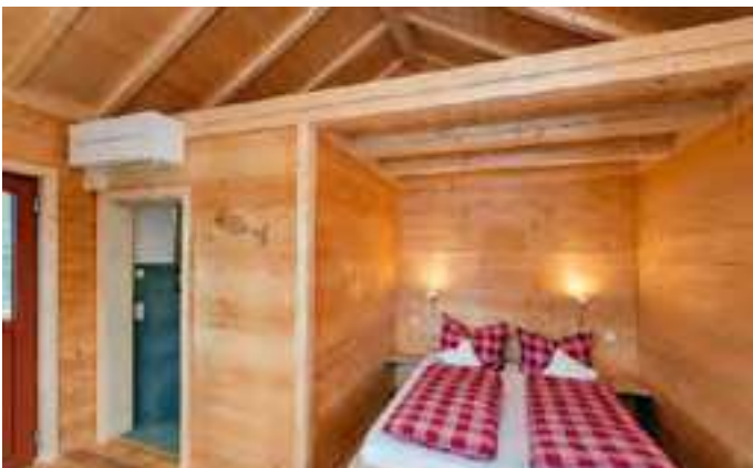
Diamond Design-Wandgerät Typ MSZ-LN klimatisiert und beheizt Baumhaushotel Bottenau
